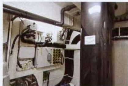
Altri impianti, non manca un inclinometro da deriva sull'albero.
