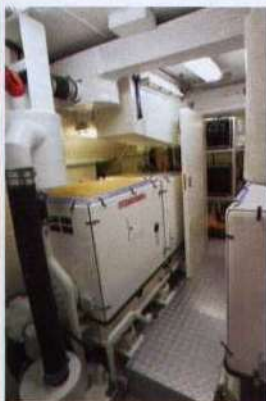
I due generatori da 45 kW in sala tecnica.
